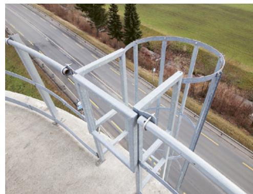
5 Sichere Gestaltung des Leiterausstiegs mit selbstschliessender Durchgangssperre.
