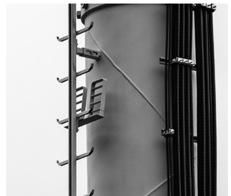
11 Ausklappbare Tritte an einer Steigleiter mit Mittelholm
