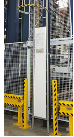
2 Ortsfeste Leiter mit Rückenschutz. Die Leiter ist mit einer abschliessbaren Sperre gegen unbefugtes Begehen gesichert.
