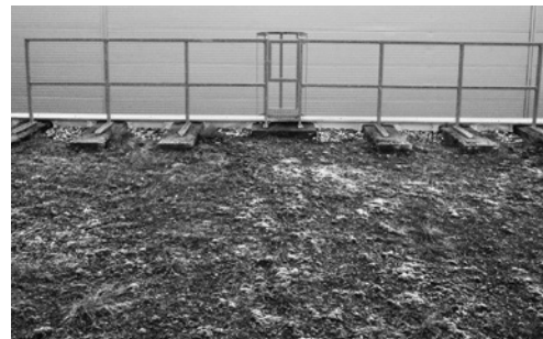
6 Geländer als Absturzsicherung auf beiden Seiten des Leiterausstieges entlang der Sturzkante
